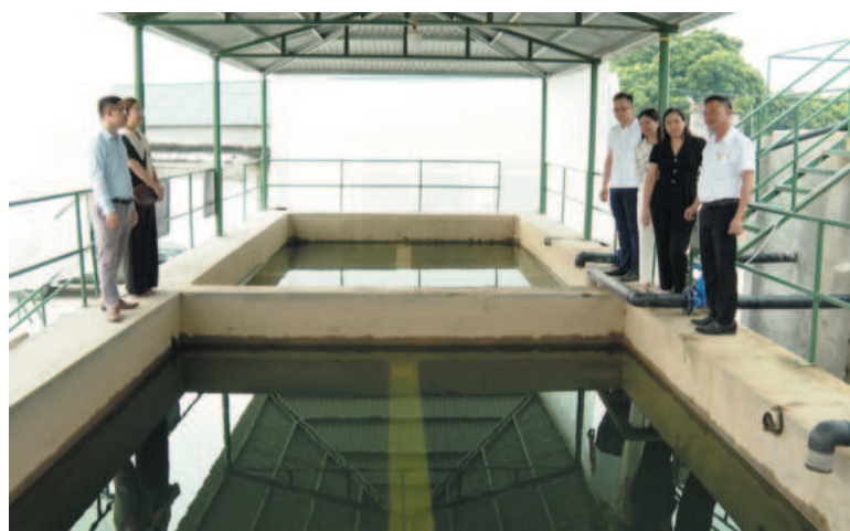
Hệ thống lọc nước của nhà máy nước xã Gia Lạc được Công ty TNHH Xây dựng Xuân Quyền đầu tư
